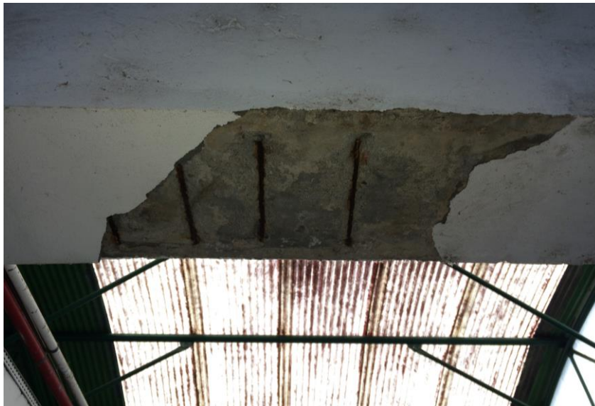
Imagem 01: Ponto comprometido na viga
