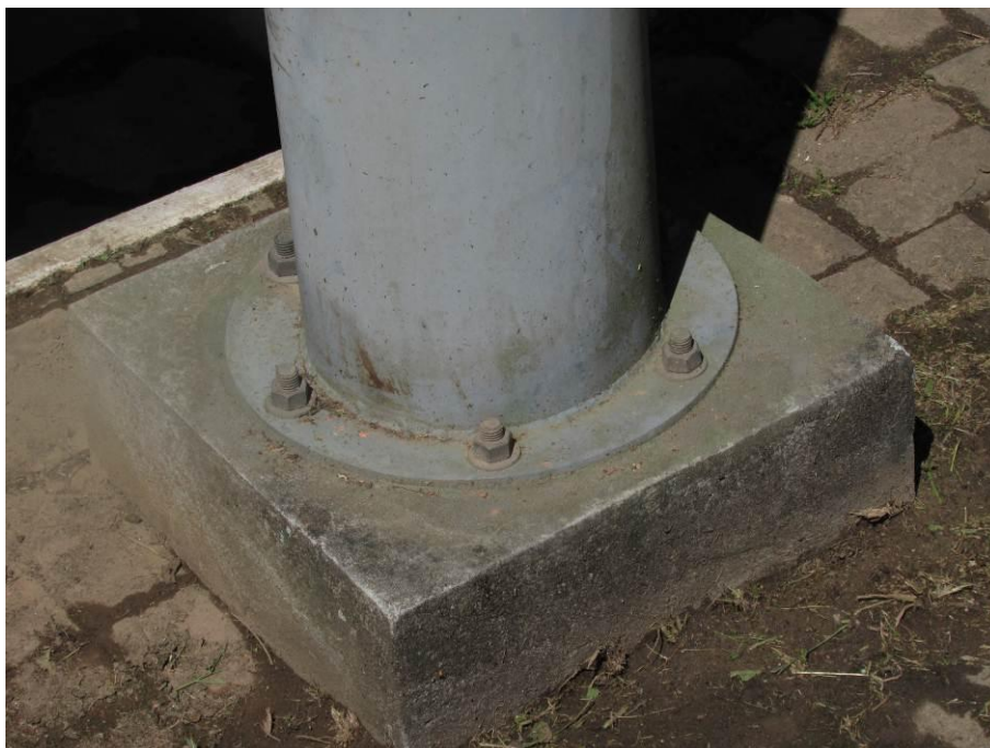
Figura 33 - União entre pilares e fundações em concreto em bom estado de conservação
