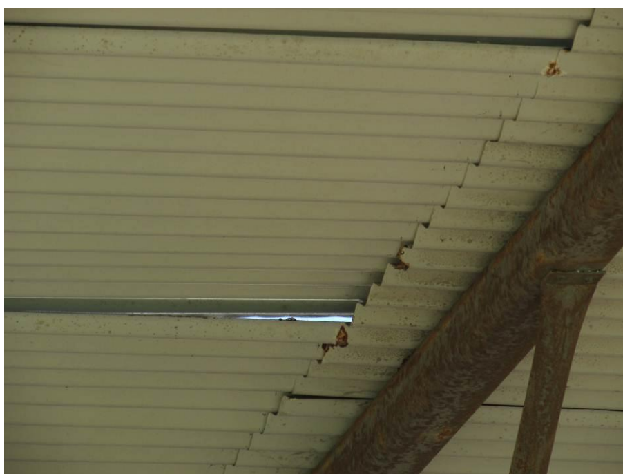
Figura 39 - Falta de fixação e presença de oxidação
