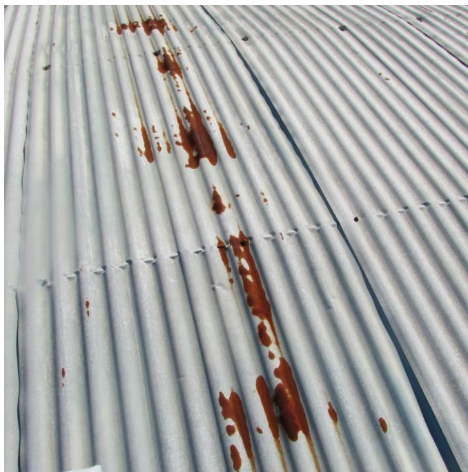
Figura 20 - Oxidação presente na face superior das telhas
