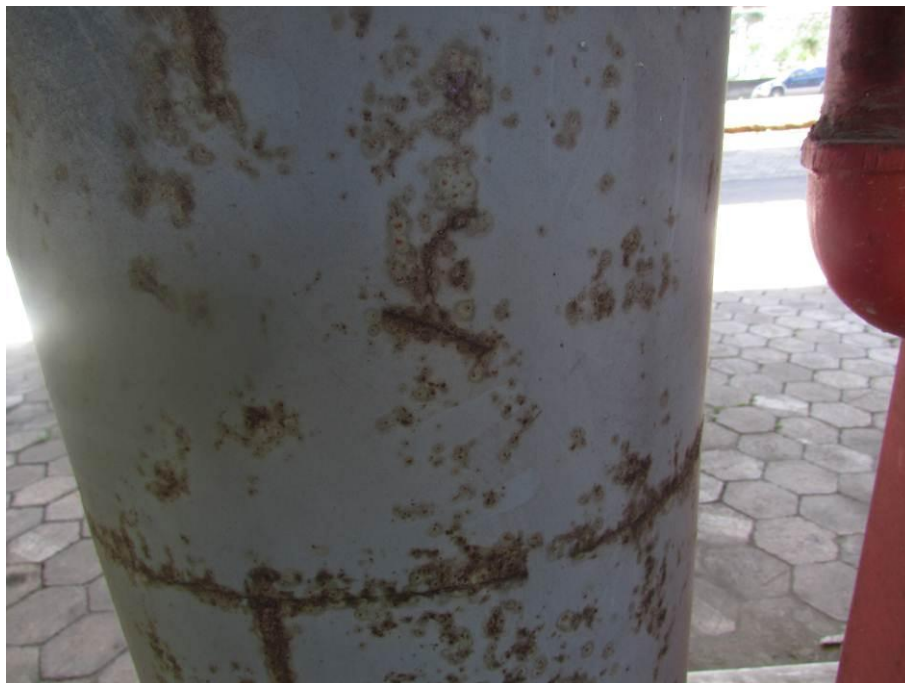
Figura 34 - coluna metálica com oxidação superficial
