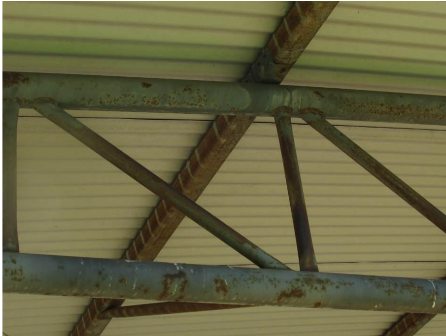
Figura 26 - Oxidação uniforme presente nas peças
