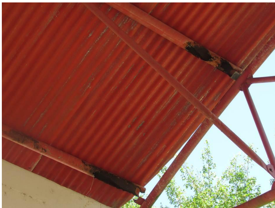
Figura 15 - Elementos rompidos por corrosão
