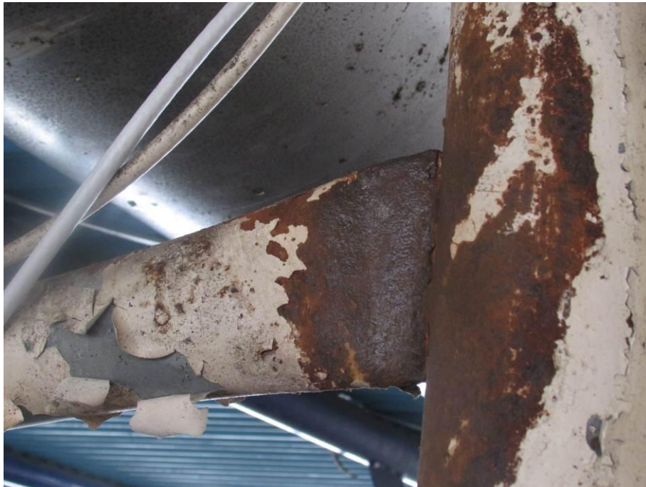
Figura 13 - detalhe da corrosão na ligação soldada e deslocamento da camada de tinta
