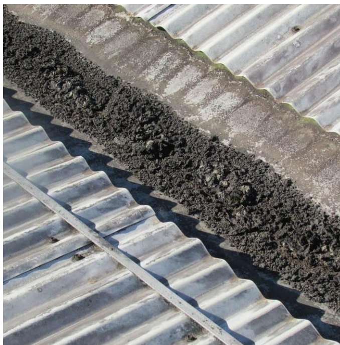
Figura 42 - Calhas com sedimentos
