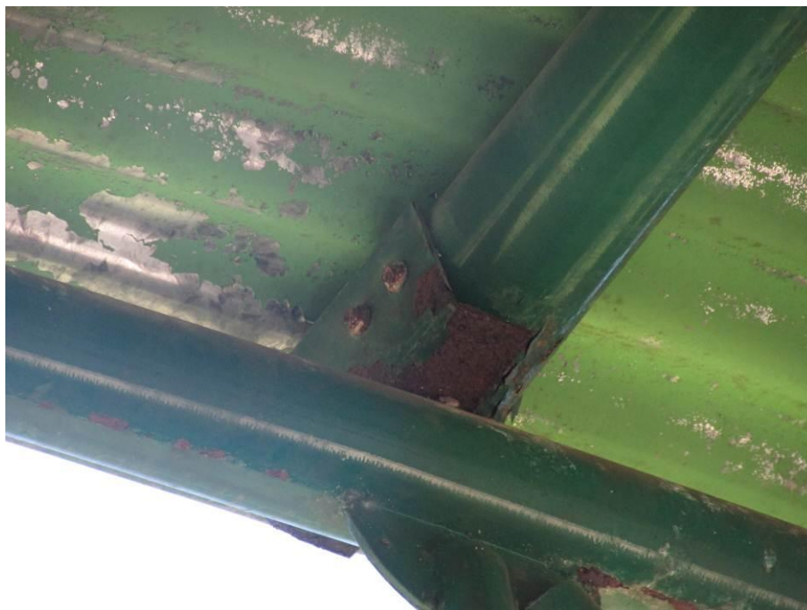
Figura 18 - Corrosão das chapas e parafusos. Detalhe do deslocamento da camada de tinta da face inferior das telhas de cobertura
