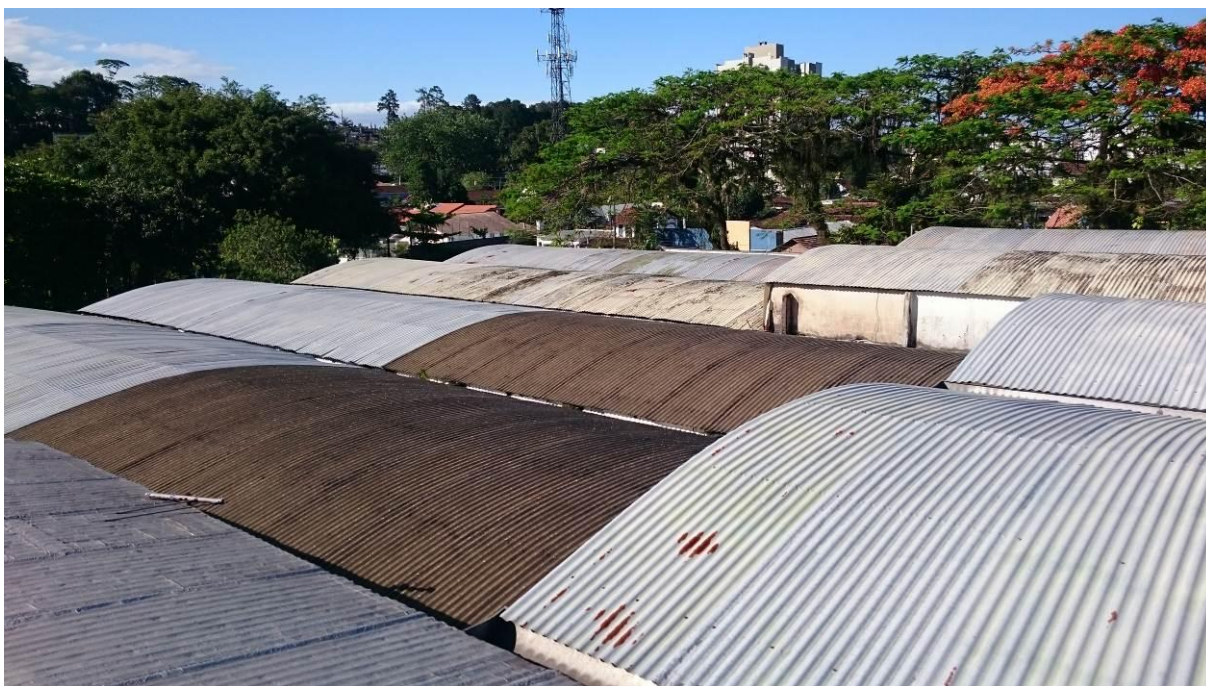
Figura 19 - Vista geral da cobertura com telhas galvanizadas e telhas em fibra (área escura)
