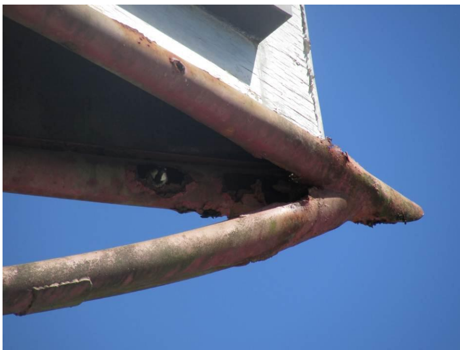
Figura 52 - Detalhe da oxidação
