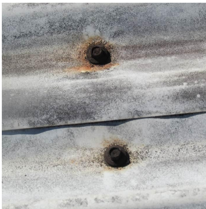
Figura 41 - Parafusos oxidados e vedações ressecadas
