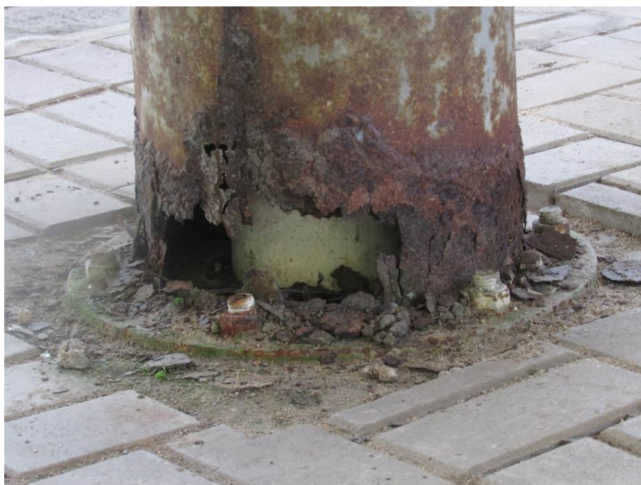
Figura 37 - Coluna com perda de seção por oxidação na base
