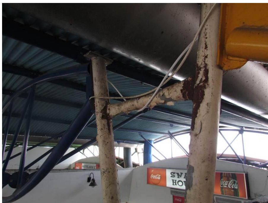
Figura 11 - Console em estado de corrosão avançado
