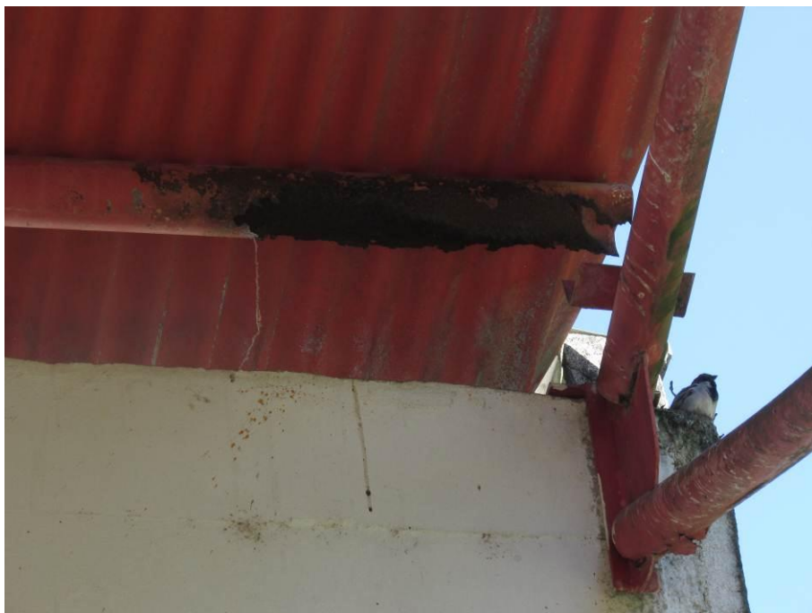
Figura 16 - detalhe do elemento rompido
