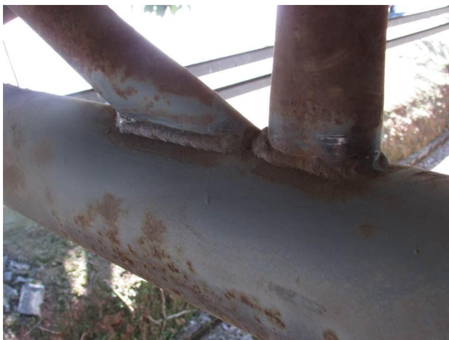
Figura 31 - Oxidação após a escovação branda
