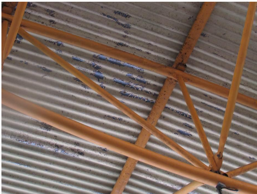
Figura 6 - Estrutura e telhas de cobertura com deslocamento da camada de pintura
