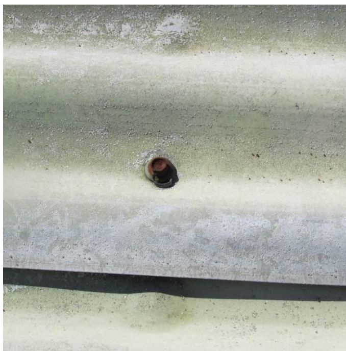
Figura 21 - Parafusos com oxidação e arruela de vedação ressecada
