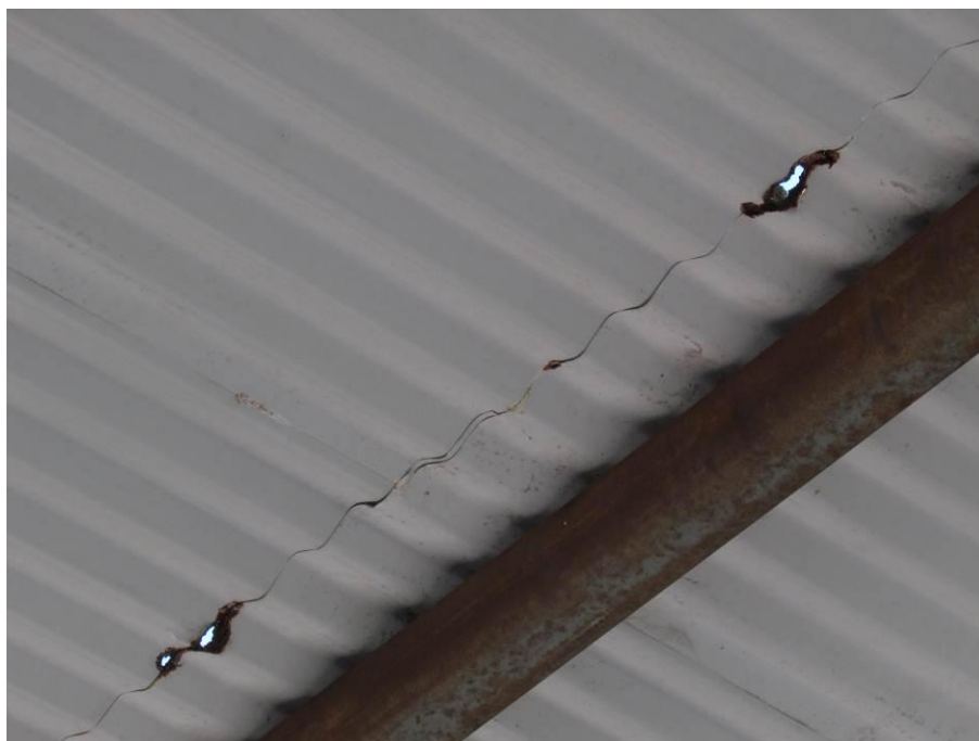
Figura 38 - Oxidação no transpasse de telhas
