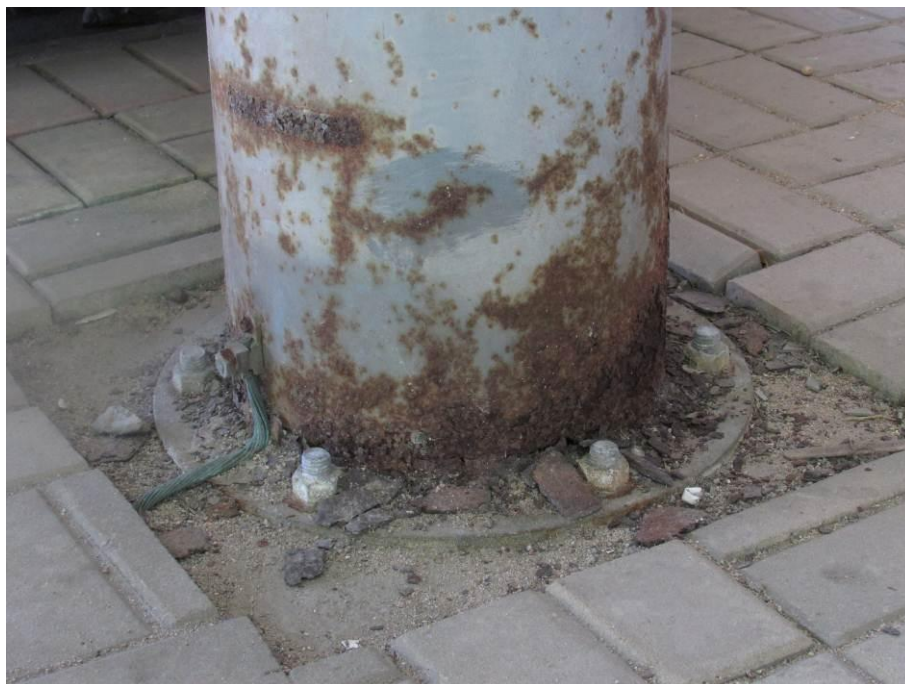
Figura 36 - Bases oxidadas (eixo entre Estacionamento 01 e 02)
